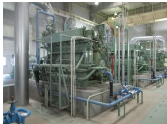
図表 2-12 管理棟内機械設備
